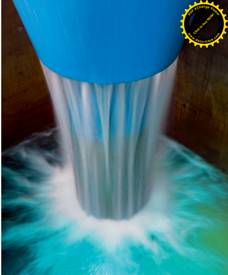
Im Wasserwerk Käfer- tal gibt es viel zu entdecken, wie diesen rauschenden Wasserfall. Über ihre Eindrücke im Wasserwerk schrieben zahlreiche Schüler für den Wettbewerb von MVV Energie einen Aufsatz
